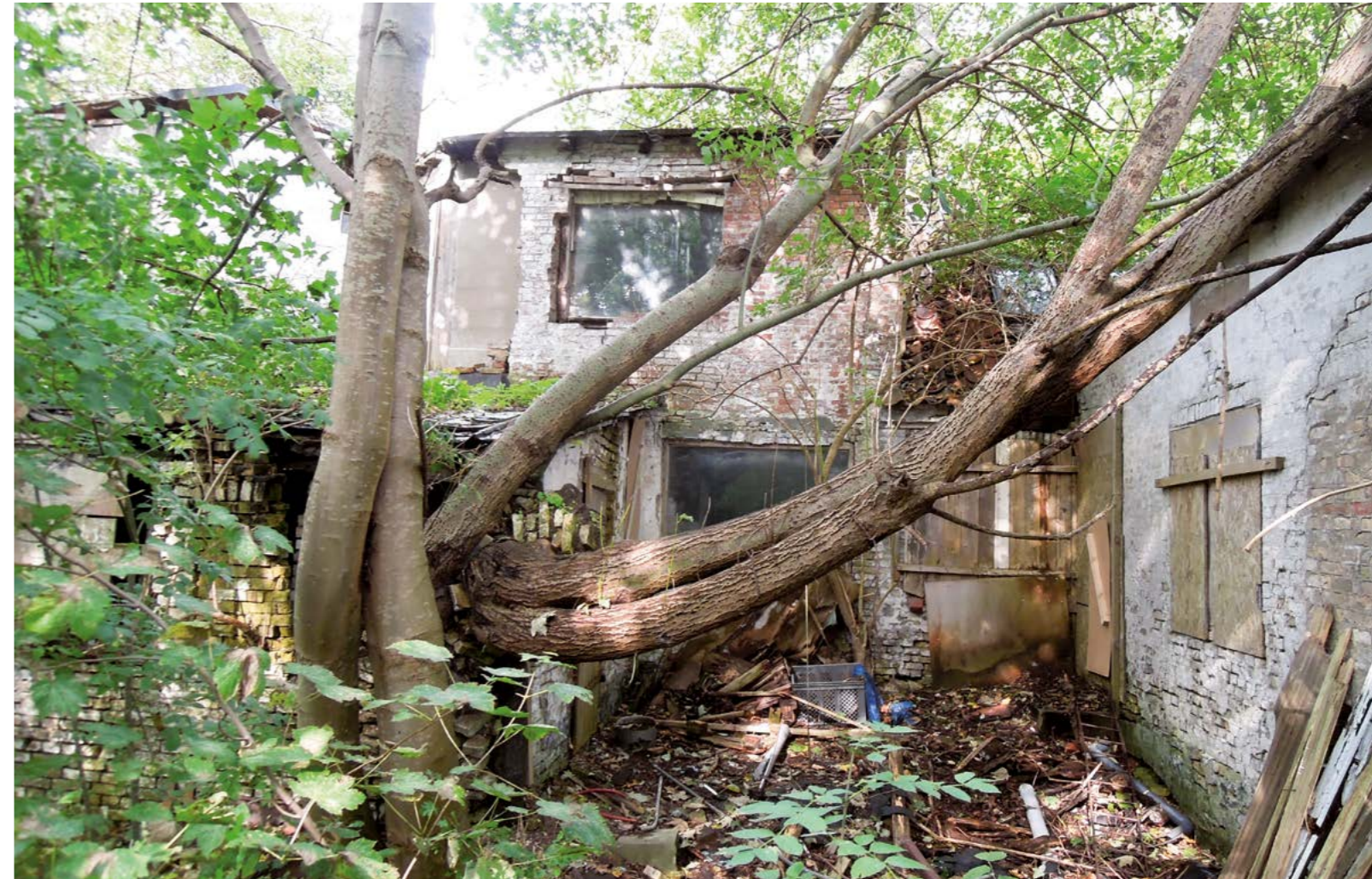
Flere kommuner har gode erfaringer med at ansætte en dedikeret boligsocial medarbejder til opgaven med kondemnering, genhusning og nedrivning. Her et ekstremt tilfælde.
